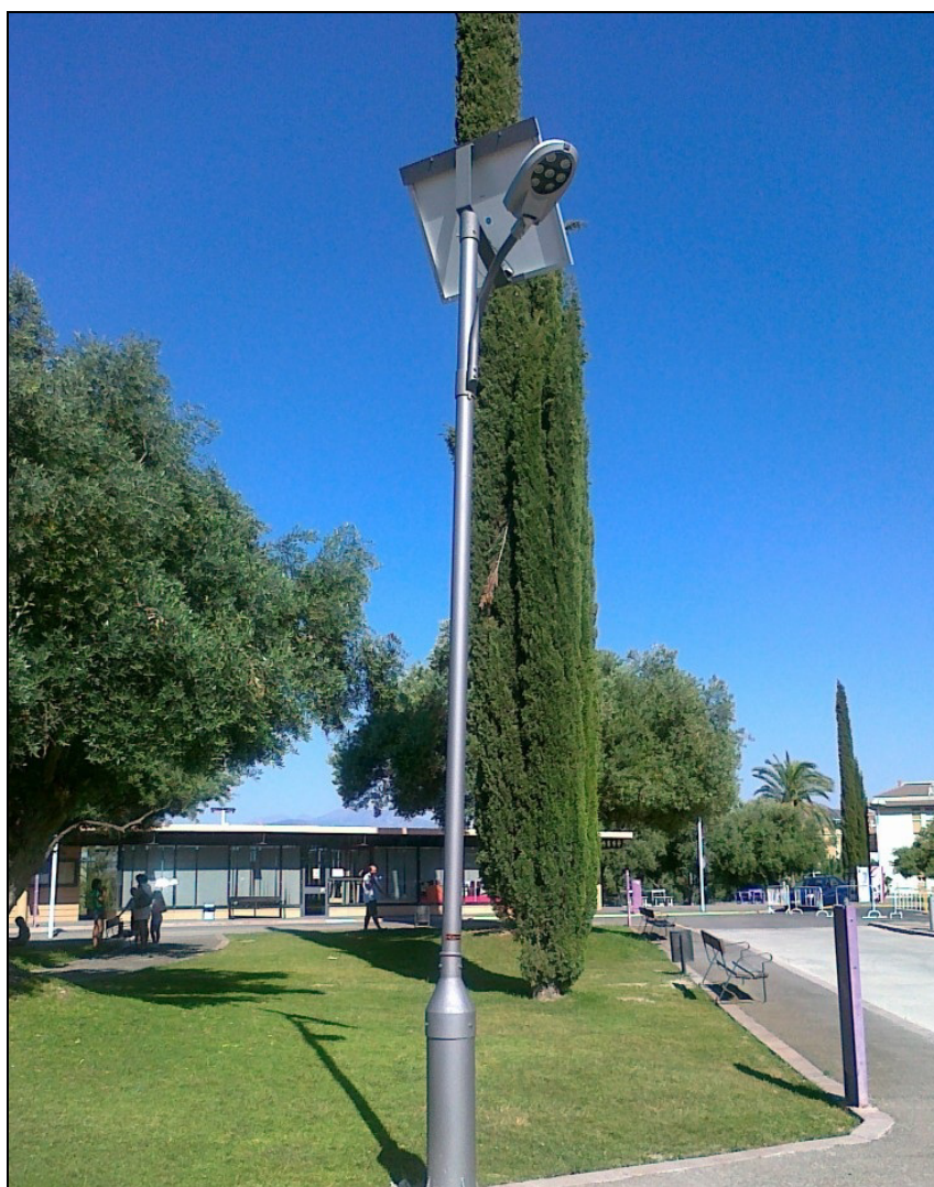
Figura nº14: Aspecto de farola solar instalada en el complejo de las Fuentezuelas, Jaén (Fuente: www.smartcityjaen.com )
